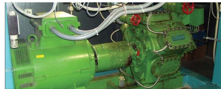
Kompressor der Wärmepumpe
